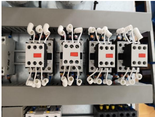
Rys. 3. Łączniki - styczniki do łączenia poszczególnych stopni
