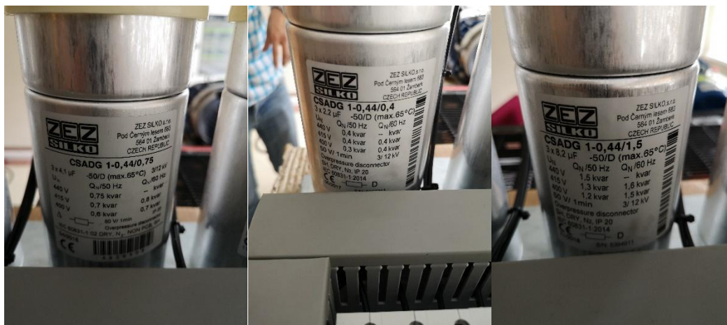
Rys. 4. Kondensatory energetyczne zainstalowane w stanowisku badawczym
